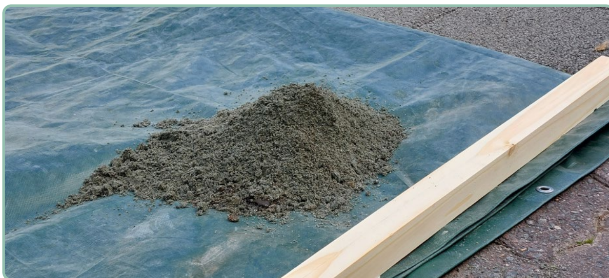
Figura 9. Armazenamento dos materiais granulares retirados da área de intervenção. Cada material deve ser armazenado separadamente, evitando-se contaminação entre eles e com o solo.
