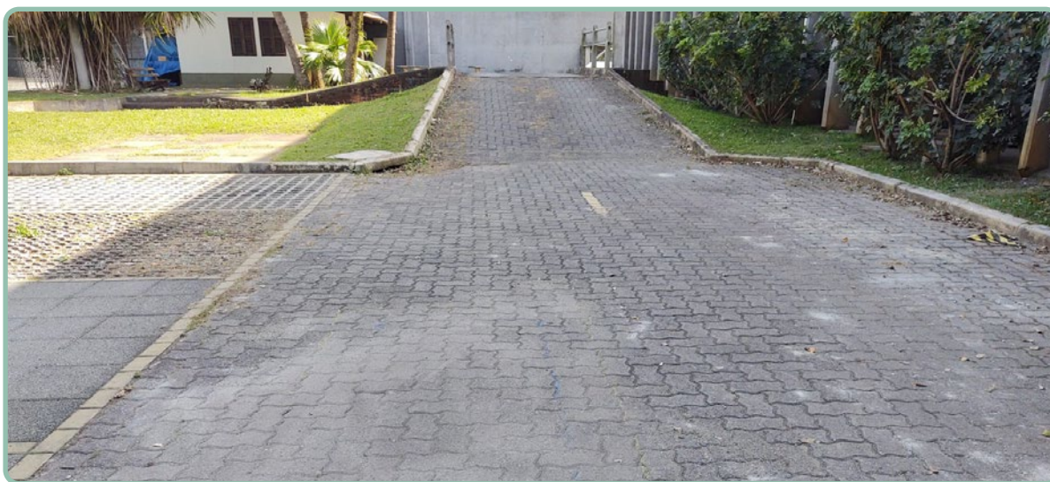
Figura 15. Pavimentos Intertravados após serem reparados não deixam marcas visíveis e nem diminuem o desempenho do pavimento.
