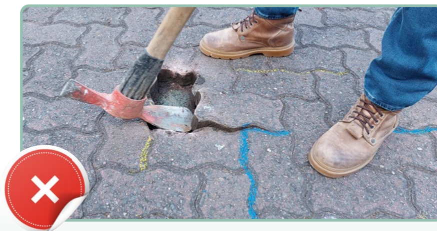
Figura 7. Nunca faça a retirada das peças forçando para cima apenas um dos lados, isso irá causar a quebra da peça.
