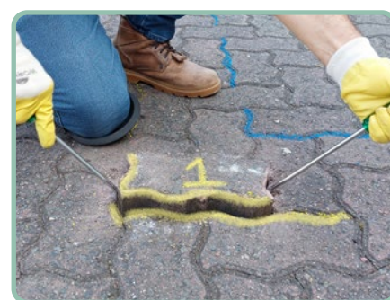
c) Alternar o uso das chaves de fenda até poder puxar a peça de concreto para fora.
