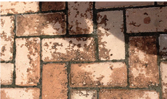
Foto 5 - Pavimento com alto índice de absorção de água
