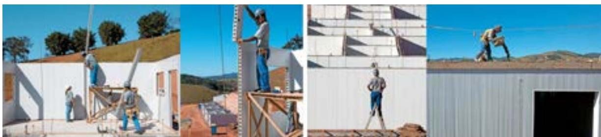
Montagem dos painéis de PVC e Concretagem ao final do processo. (Foto disponível em: http://saoluizparaitingafaus2012.blogspot.com.br/2012/11/73-habitacao.html )
