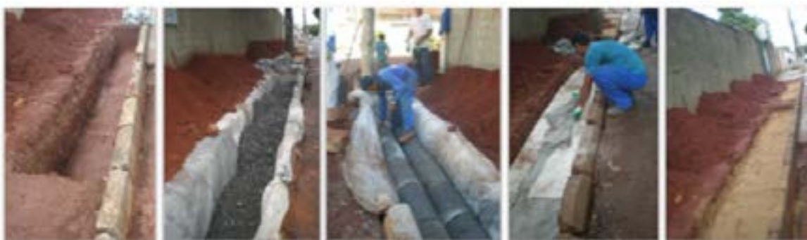
Valas de infiltração colaboram com a drenagem urbana (Crédito: Pirâmide Engenharia)
